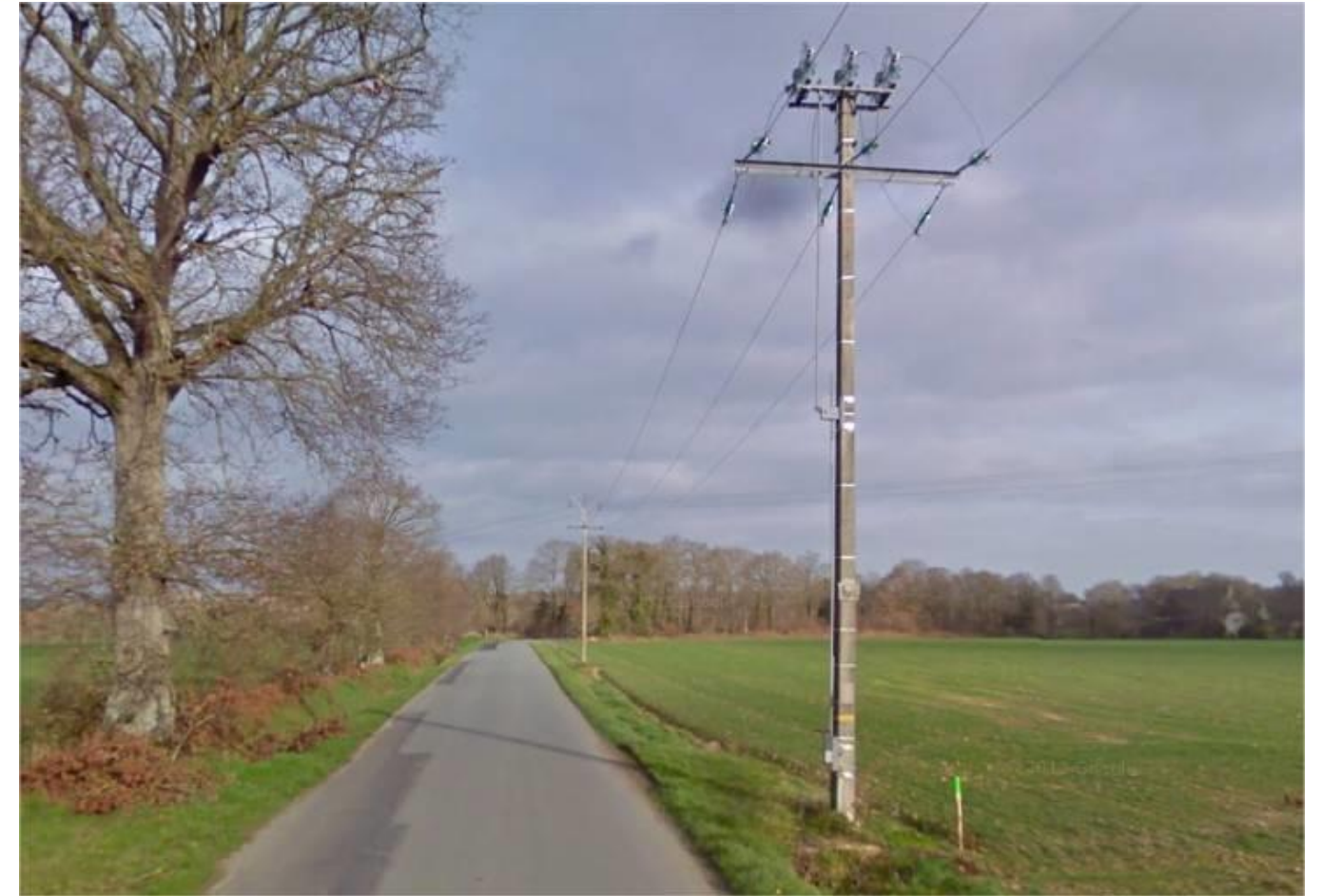
Photo 1 : Illustration d'un réseau de distribution d'électricité aérien en 20 000 V à Plestan
